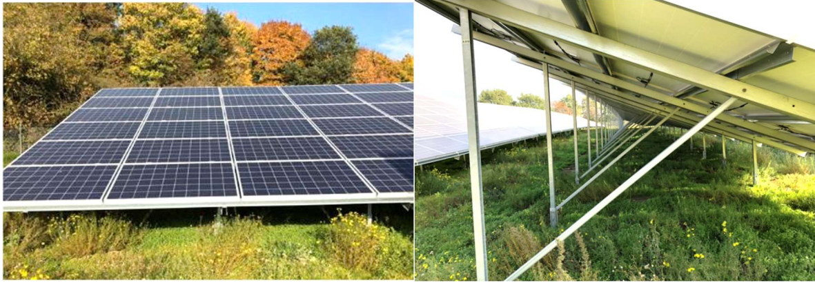
Abbildung 7: Beispiel aus Emkendorf für eine Photovoltaik-Freiflächenanlage desselben Vorhabenträgers (Quelle: SolarWind Projekt GmbH, Hamburg)
